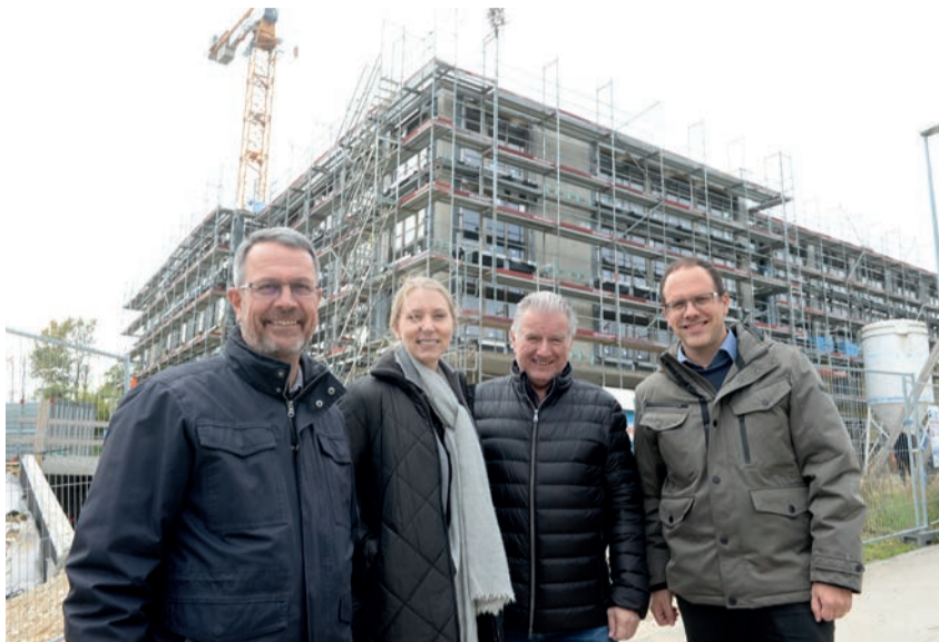
André Allmendinger, chargé de projet, Marcia Akermann, architecte, Claude Recordon, président, et Luis Villa, directeur de la Fondation Saphir devant le bâtiment. DR
